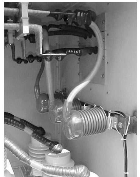
현장 설치 모습
